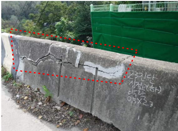
내용 접속부 방호벽 박락 (하행 S3)
