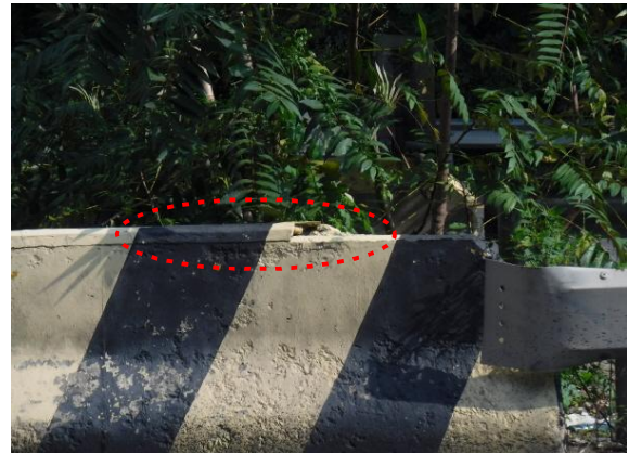
내용 방호벽 파손 (하행 S1)
