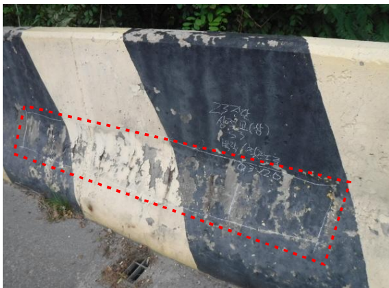
내용 방호벽 박락 및 철근노출 (상행 S3)
