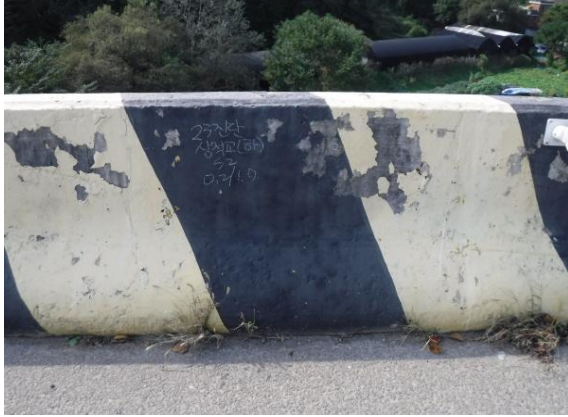
내용 방호벽 균열(cw=0.2mm) (하행 S2)
